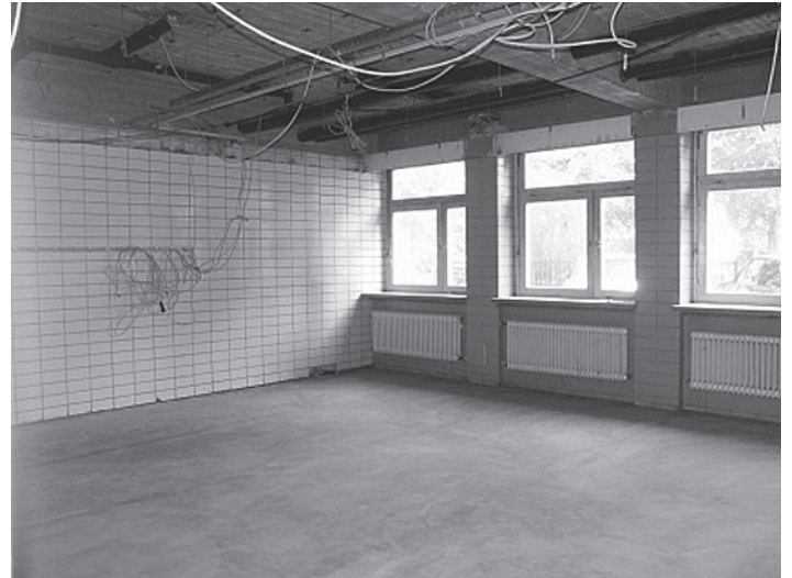
Blick in den ausgebrannten Raum 58
